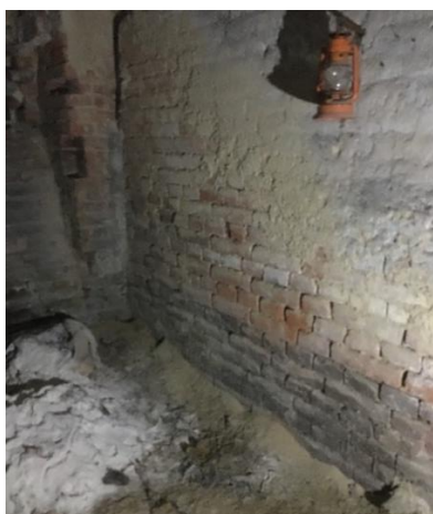
Zdivo sklepa nájemníků je bez větších degradací cihly, ponechá se rezné
