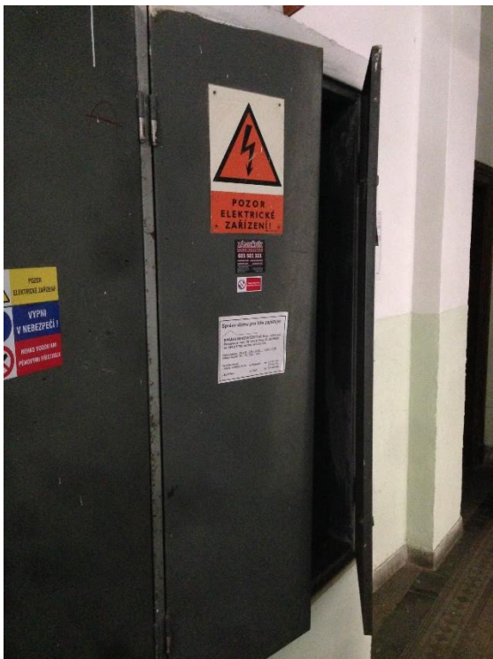
Foto č. 57 elektrický rozvaděč na chodbě
