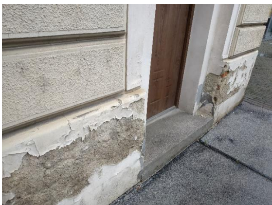
Foto č. 23 Poškozená fasáda z luční části Vídeňská
