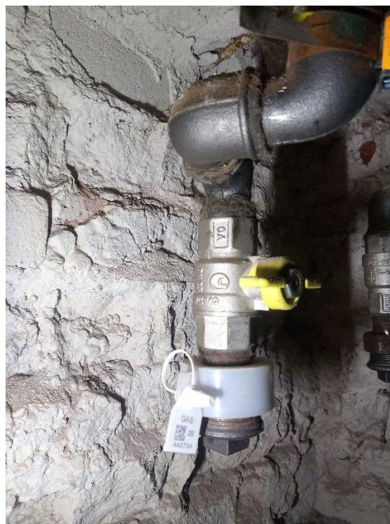
Foto č. 46 Hlavní uzávěr plynu v 1.PP
