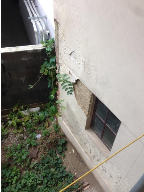
Foto č. 51 Poškozená omítka na dvoře
