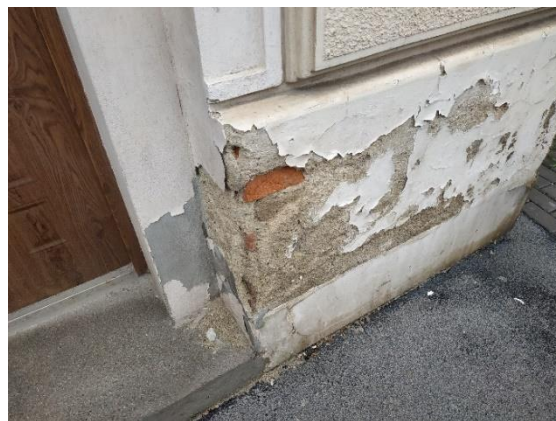
Foto č. 24 Poškozená fasáda z luční části Vídeňská
