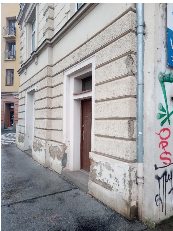
Foto č. 25 Poškozená fasáda z luční části Vídeňská
