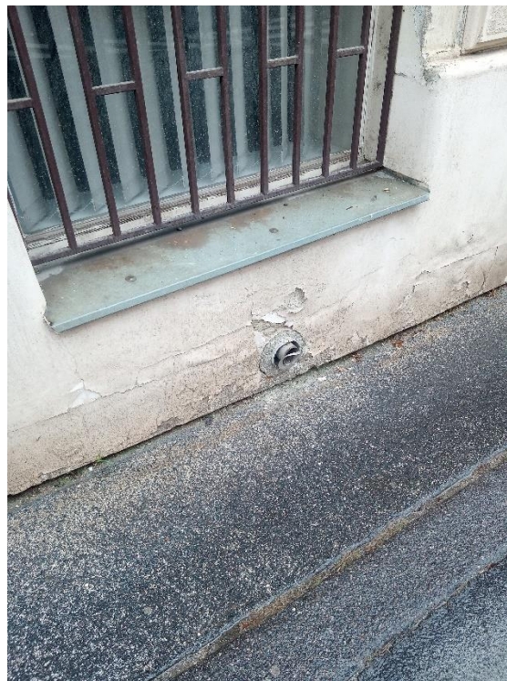
Foto č. 30 Vnější parapet oken v 1.PP
