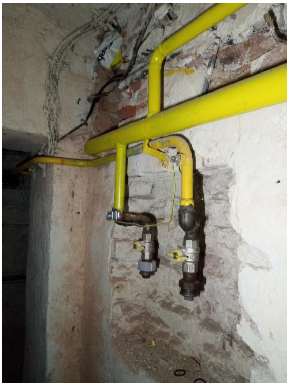
Foto č. 43 Hlavní uzávěr plynu v 1.PP
