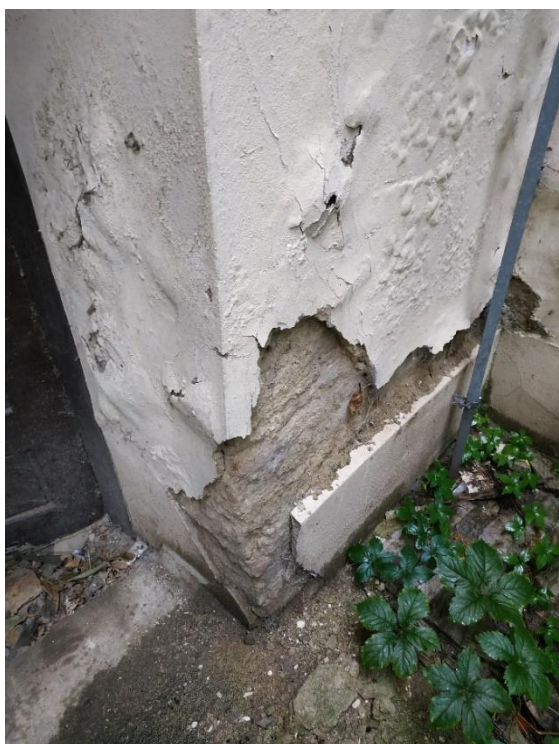
Foto č. 49 Poškozená omítka na dvoře
