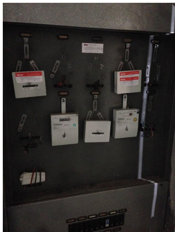
Foto č. 58 elektrický rozvaděč na chodbě
