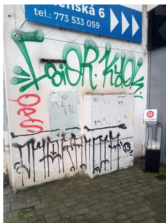
Foto č. 26 Poškozená fasáda z luční části Vídeňská
