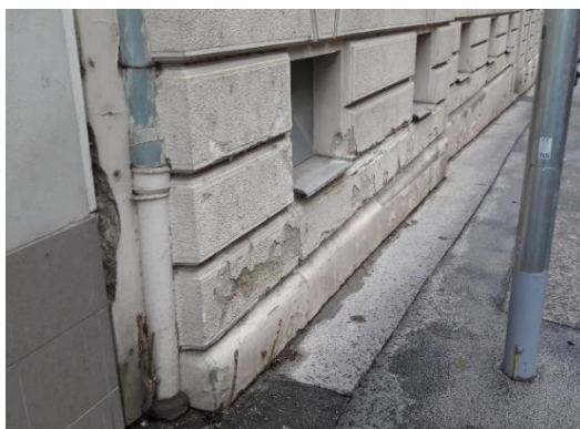
Vnější omítky jsou degradované na výšku okolo 1,2 m. Veškeré solemi nasycené omítky je třeba vyměnit a provést vysoce pórovité sanační omítky, aby zdivo mohlo průběžně vysychat.
