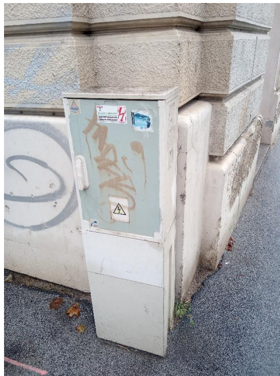
Foto č. 28 Elektrický rozvaděč
