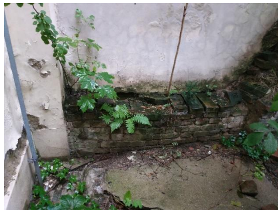
Foto č. 48 Poškozená zídka na dvoře
