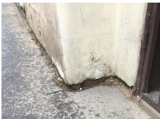
Pata zdiva je obnažená na cihlu, do zdiva ta přímo z trénu zatéká
