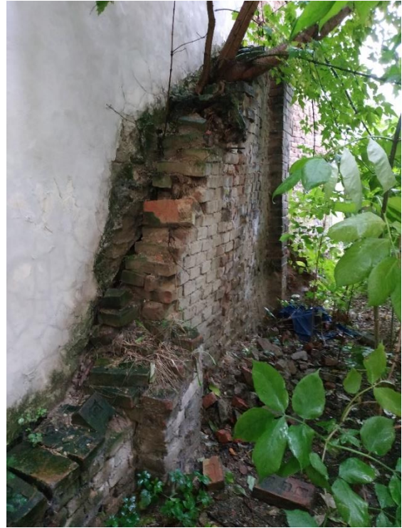
Foto č. 52 Poškozená zídka na dvoře
